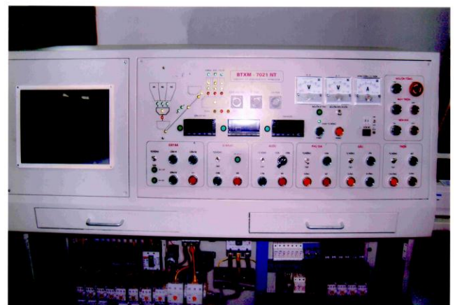
Tủ điều khiển trạm trộn bê tông nhựa, bê tông xi măng
